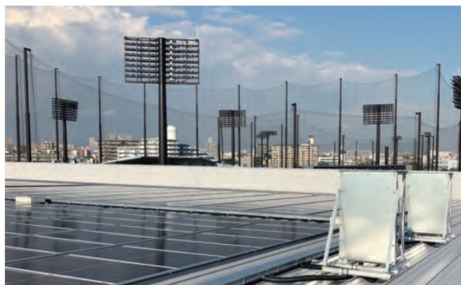
▲選手寮の屋上に設置した太陽光パネル
