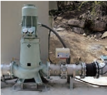
▲発電所に設置されているポンプ逆転水車は日本製（大見機械工業製）。ベルト水車の海外製ほど効率は良くないがシンプルな構造でメンテナンスが容易なのだそうです。
